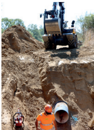
Chantier de raccordement du Lac de Taure à l'usine de traitement de Maquens.
